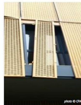
Gonds montés à l'envers et trop courts pour permettre au boulon frein filet de ne plus se dévissier.
