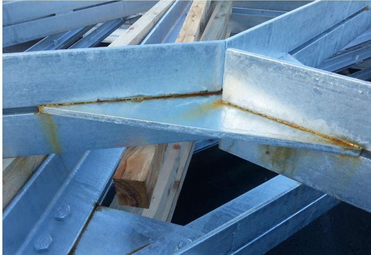
Intervalles étroits : ressuage constaté après galvanisation sur une poutre treillis
